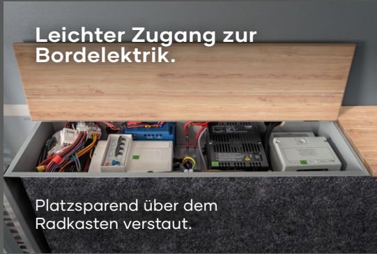
Leicht zugängliche Bordbatterie.
